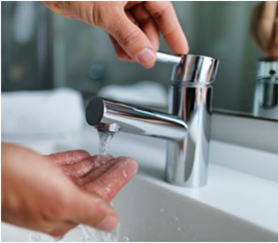
Hochwertige Armaturen namhafter Hersteller (z.B. Grohe oder gleichwertig)“
